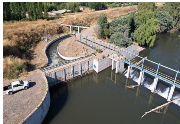
Bocatomas Las Toscas. Compuertas de admisión Canal Matriz Nilahue tramo 1 en normal funcionamiento.
