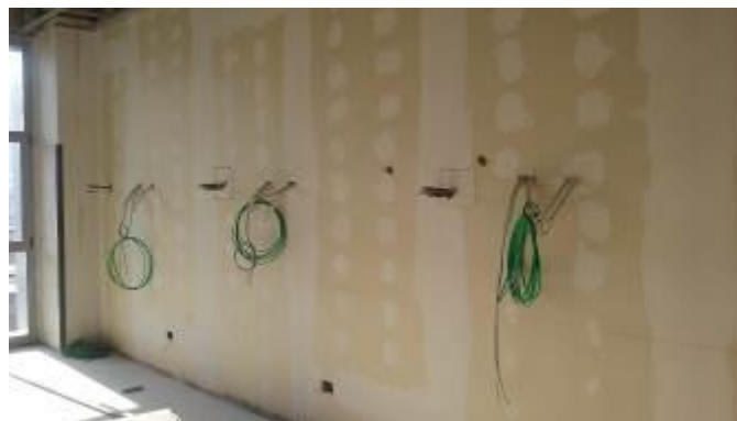
Avance hasta el 7° piso en cuanto a redes de gases clínicos. Edificio Th Hospitalización
