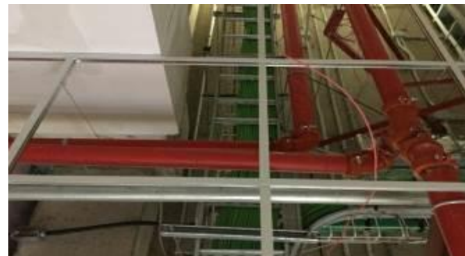
Tubería de red húmeda en los shaft
