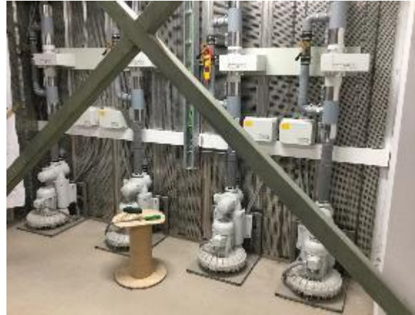
Vista turbinas de la sala de transferencia de correo neumático piso -1
