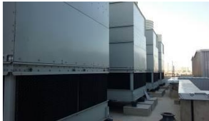
Torres de refrigeración nivel 4 Piso mecánico
