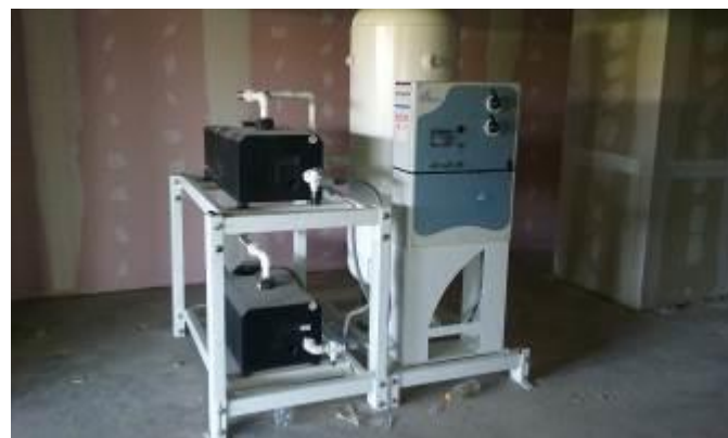
Central de extracción de gases anestésicos
