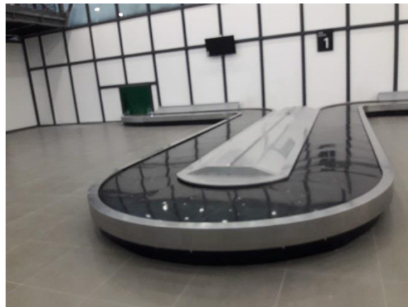
Edificio Control y Servicios - Cintas transportadoras
