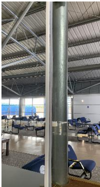
Reparación separación encontrada en termo paneles sector ex restaurante
