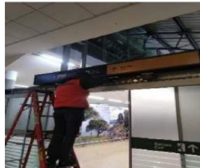
Mantención Puertas Automáticas
