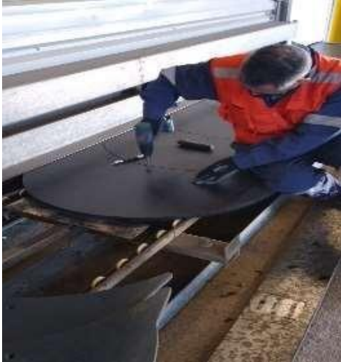
Mantenciones efectuadas, Aeropuerto ítem B-8 CINTA TRANSPORTADORA DE EQUIPAJE
