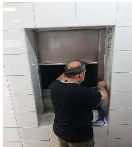
Mantenciones efectuadas, Aeropuerto ítem B-4 MONTAPLATO
