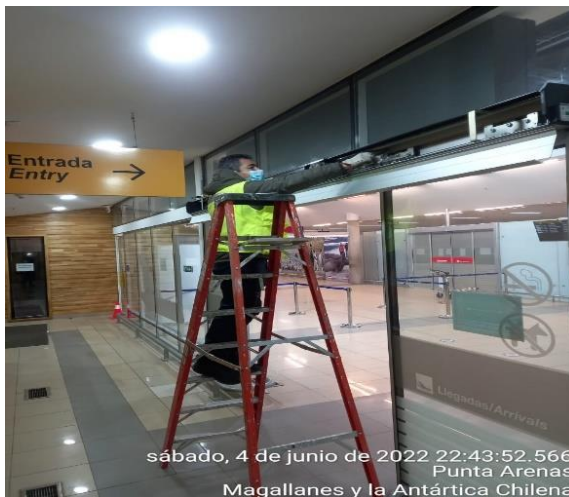
Mantenión Puertas Automáticas
