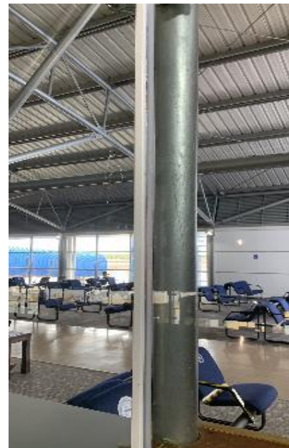
Reparación separación encontrada en termo paneles sector ex restaurante
