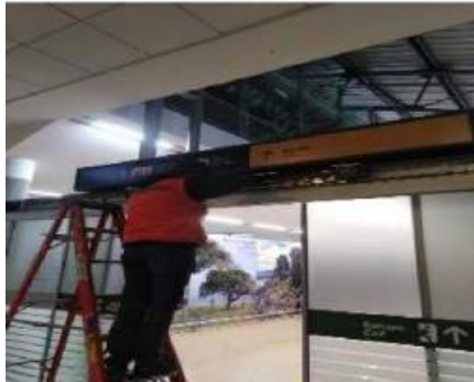
Mantenimiento Puertas Automáticas
