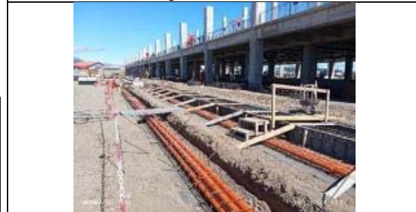
Bancoductos Proyecto AVI camino aeronáuticos.
