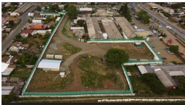
Recinto del Hospital de Nacimiento. Diciembre 2022. Trabajos de obras preliminares. Cerramiento preliminar. Instalación de portón
