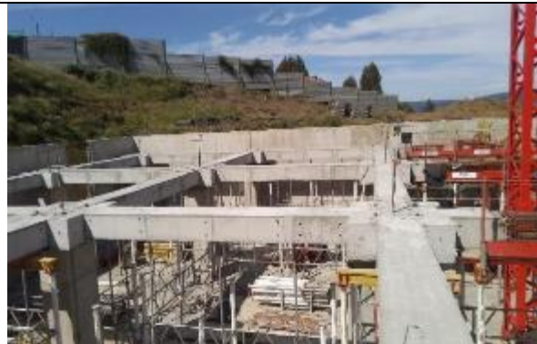
Muestra instalación de aislador sísmico sobre capitel en sector noreste del nivel S3
