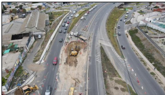
Foto 1: Ruta 5, Dm 462+000 socavón Juan Antonio Ríos.
