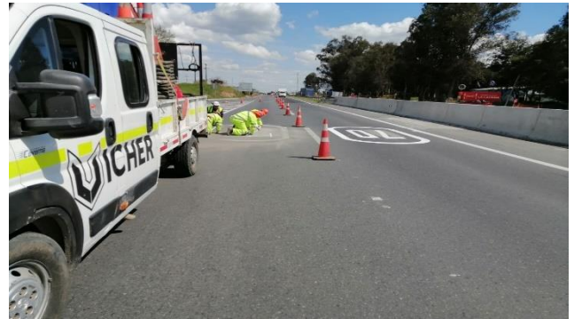
Trabajos en peaje Río Claro, consisten en demarcación y cambio de señalización en km 220,750.
