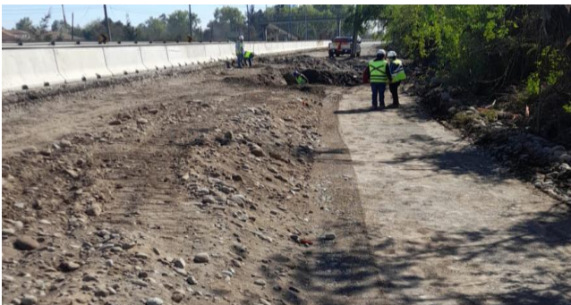
Trabajos en instalación de Obra de Arte peaje Troncal de Retiro Km. 322,400.
