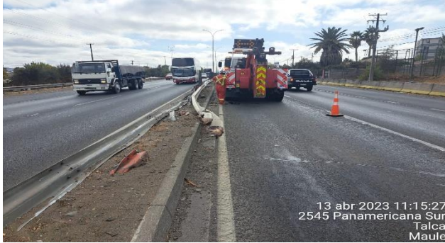
13 abr 2023 11:15:27 2545 Panamericana Sur Talca Maule Sector con daño de defensa en la medina, km 254,420.
