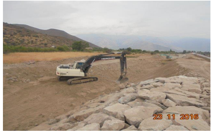
Construcción Defensas Fluviales , Se trabaja en diversos sectores, en la foto el Dm 22.860
