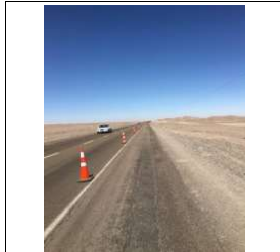
Vista de Área Seguridad para Trabajos de cambio de señalización - Ruta 25 (Sector A)
