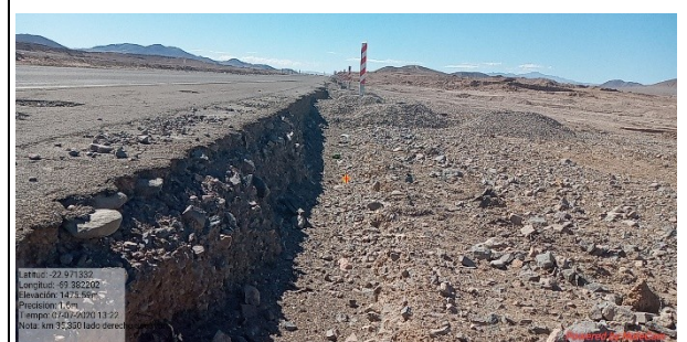
Foto N° 04 Desnivel en Ruta 25
