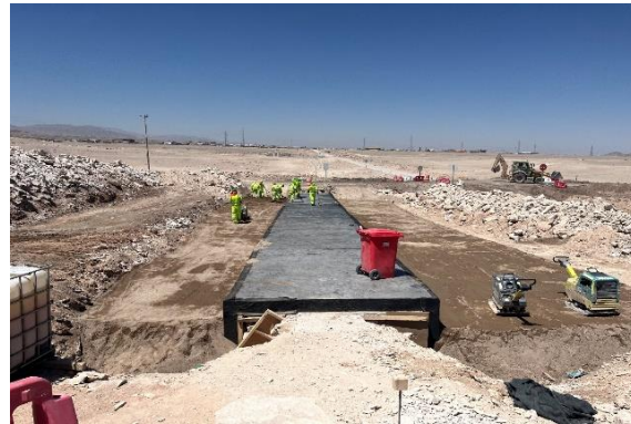
Foto N°05 Cajón Protección ENEL. Km 20. Sector B
