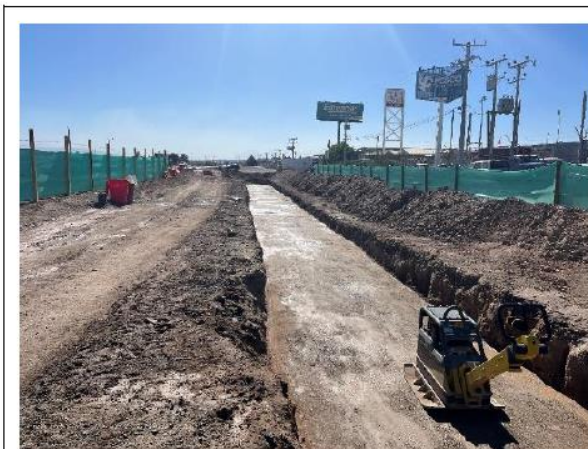
Foto N° 01 Colector de Aguas Lluvias Sector APIAC
