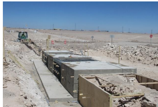
Foto N°06 Cajón Protección ENEL. Km 20. Sector B
