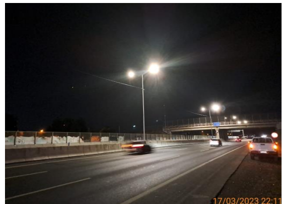
Habilitación de energización en el sector Terceras Pistas Santiago-Talagante: instalación de luminarias, postes SOS, CCTV y PMV. Considera comunicaciones 4G inalámbrica para las cámaras CCTV
