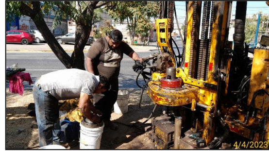
Imágenes 1 y 2: En el km. 0,08 (aprox.) se realizan trabajos de sondajes en calzada derecha, Sector Isabel Riquelme (trabajos corresponden a obras de Estudios de ingeniería)
