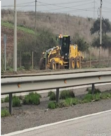
Rep. superficial de pavimentos en CS Sur- km. 81+000
