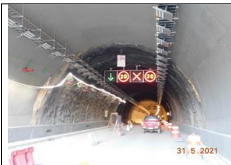
Red Incendio en unión túnel falso y nuevo
