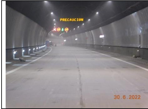
Panel de Mensajería Variable en funcionamiento, Túnel 2
