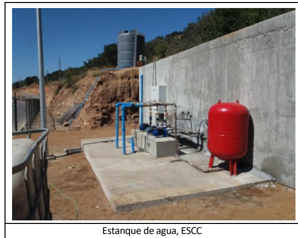
Estanque de agua, ESCC
