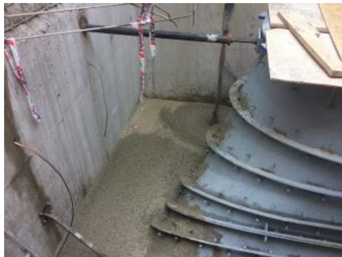
Hormigonado 3ª capa del Difusor U2, lado sur. Son 14 m 3 de H25. 12/04/2017.
