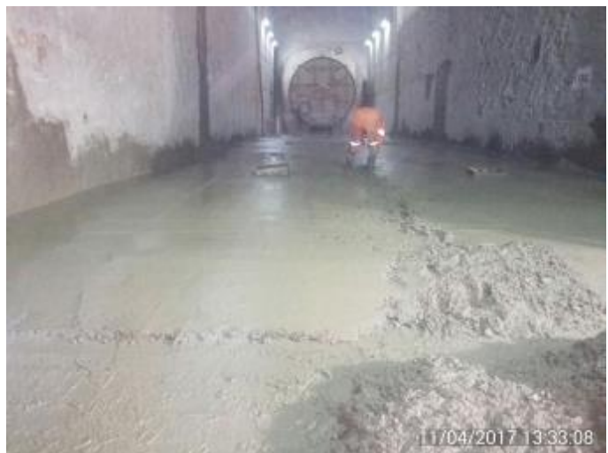
Hormigonado del Piso de Refuerzo del sector demolición de la Cámara de Válvulas. Son 49 m3 de H30. Se aprecian los recesos para los pernos de las Fundaciones de la Tubería en Presión.
