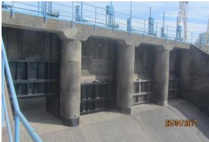
Compuertas canal Teno-Chimbarongo
