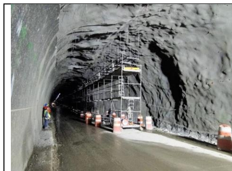
Instalación EPC, Túnel I
