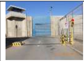
Figura 2. Mantención del Sistema de Barrera Acceso Vehicular.
