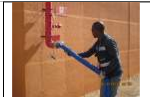
Figura 1. Se realizan pruebas y mantención a la Red Húmeda y Red Seca.
