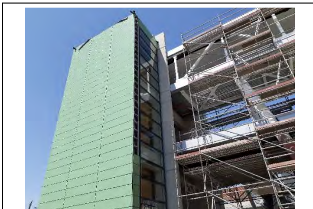
T2M: Detalle de instalación de revestimiento de torres acceso a puentes de cuarto nivel.
