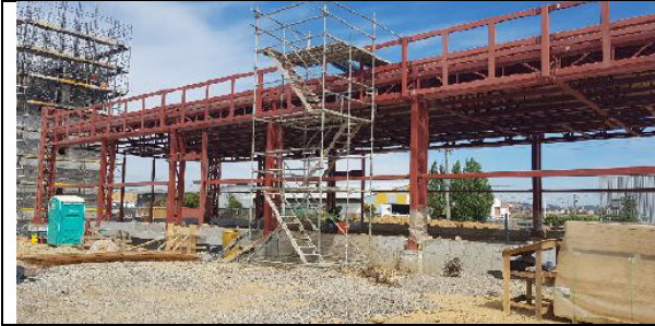
Centro de Control de Mantenimiento
