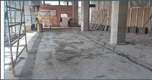
Area de oficinas Líneas Aéreas
