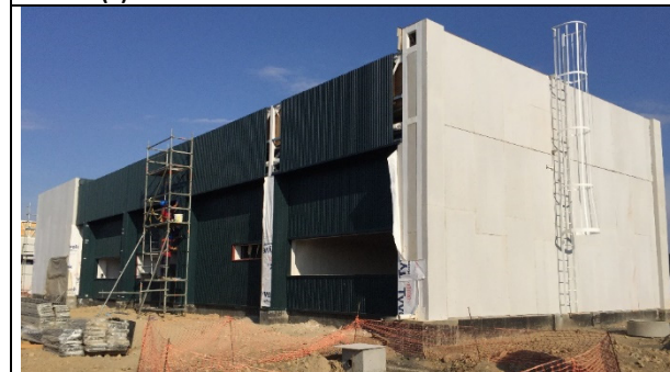
Centro de Control
