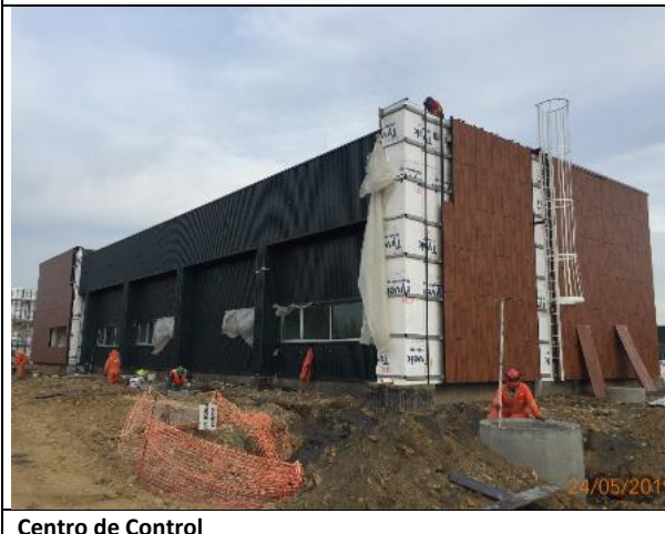
Centro de Control
