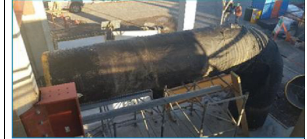
Ampliación Sistema de Clima
