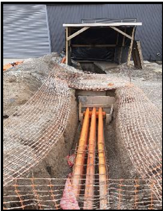
Banco de ductos
