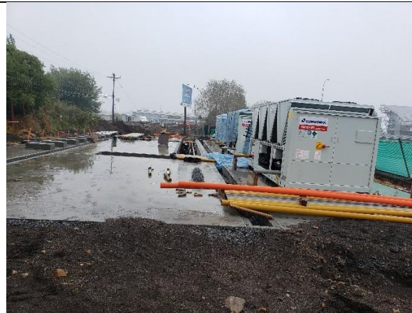
Equipamiento de la central térmica
