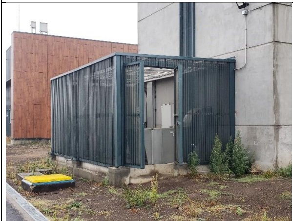
Presurizador para agua potable Torre de Control
