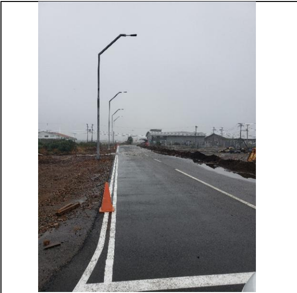
Nuevos postes de iluminación LED
