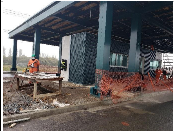
Control de acceso a edificios DGAC
