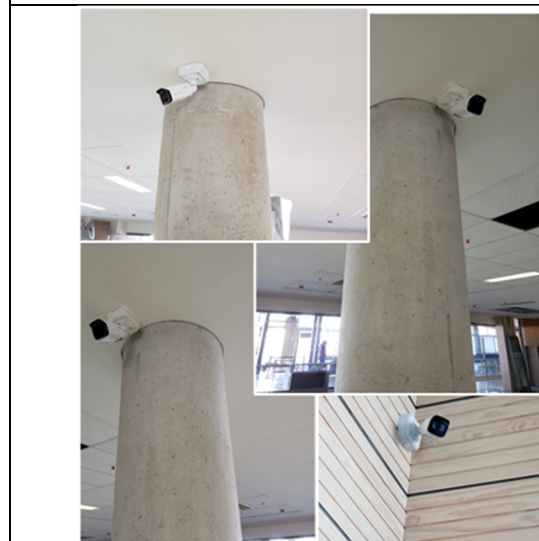
Nuevos sistemas CCTV
