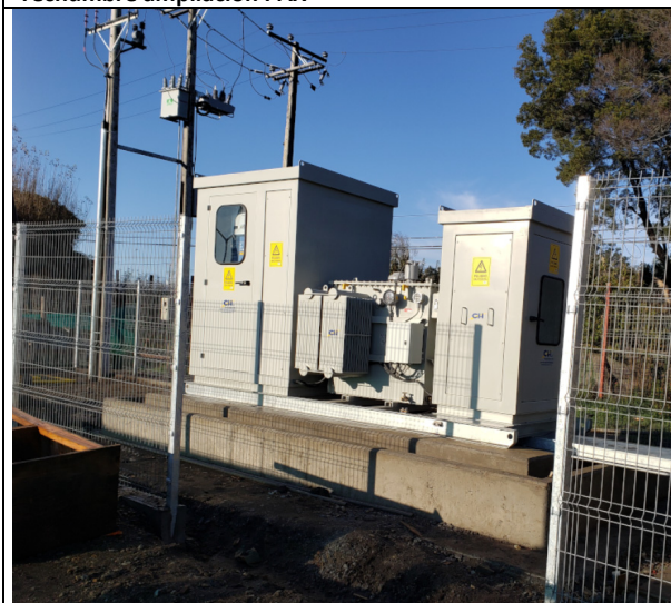
Sub Estación Eléctrica para Central Térmica
