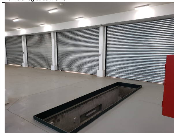
Cortinas plegable mecánicas en Edif. Logístico
