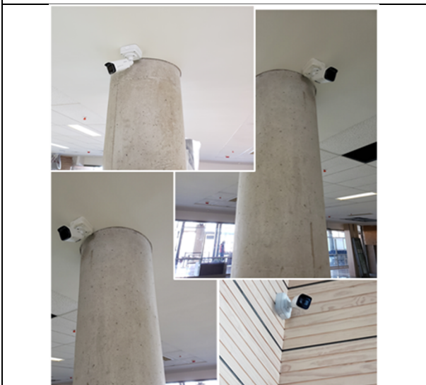
Nuevos sistemas CCTV
