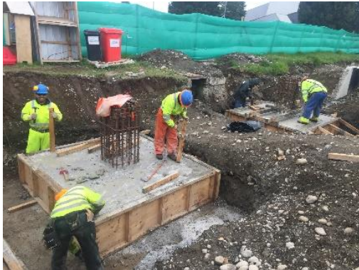
Fundaciones Cuartel SSEI provisorio
