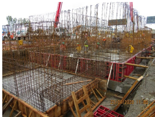
Estanque de agua potable
