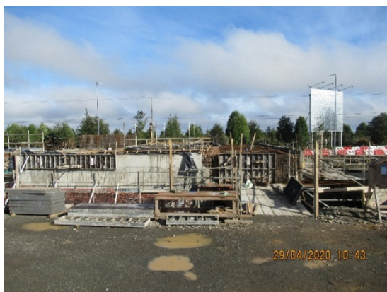
Planta de Tratamiento de Aguas Servidas
