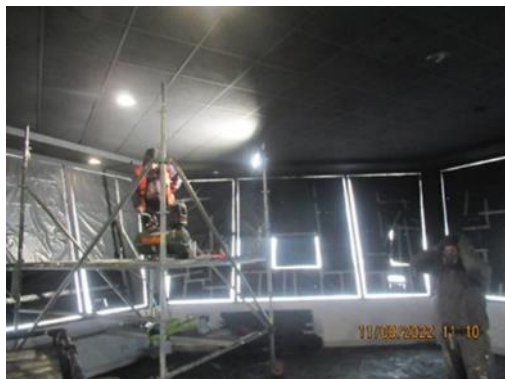
Torre de Control: PINTURA NEGRA OPACA EN CIELOS DE CABINA
