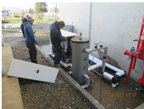
Torre de Control: REGULACIÓN EQUIPOS DE CLIMATIZACIÓN
