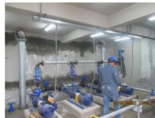
Estanque de Agua Potable: REGULACIÓN BOMBAS DE IMPULSIÓN
