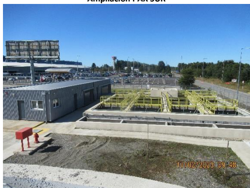
Planta de Tratamiento de Aguas Servidas (PTAS)
