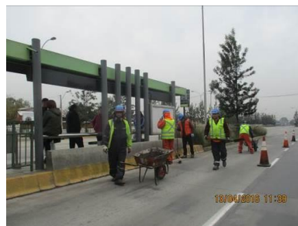
Sello de Juntas en tramo 2
