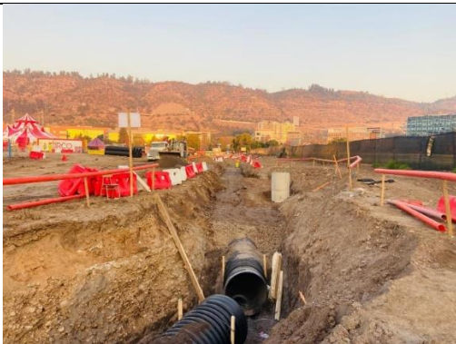
Tubería de AALL
