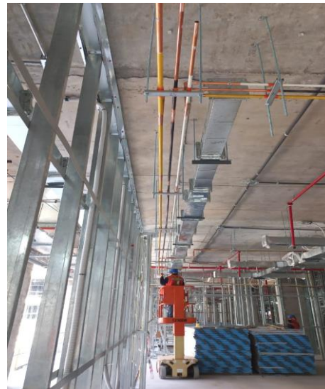
Tubería gases clínicos edificio HDS.
