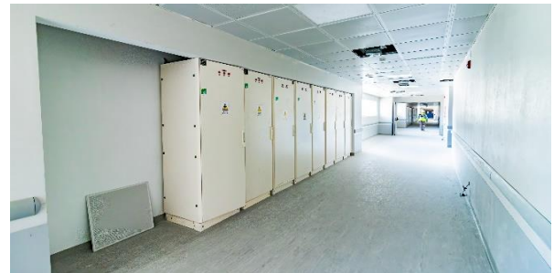
Respaldo eléctrico Pabellones
