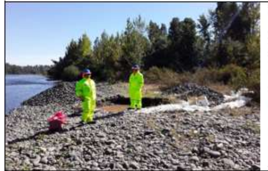
Ilustración N°3: Sondajes Puente Coihue
