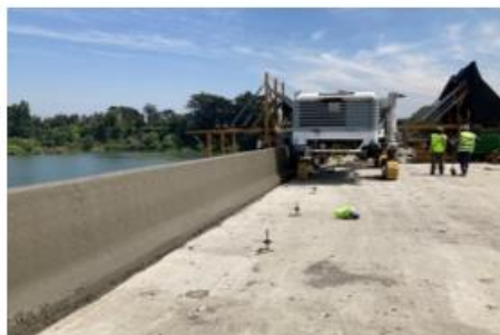
Ilustración N°2: Defensa tipo F Hormigón Estrusado Puente Cuihue
