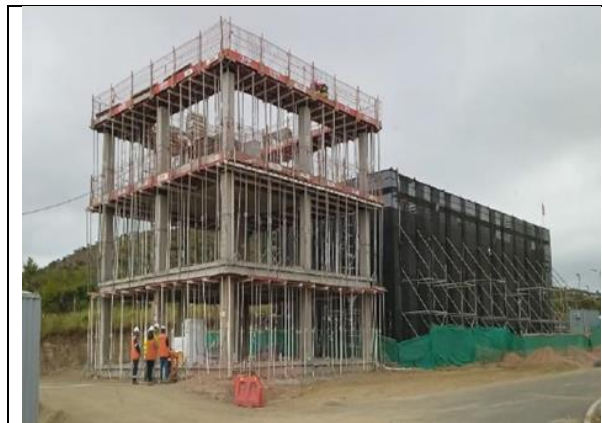
Edificio de administración e IF en Área de Servicios
