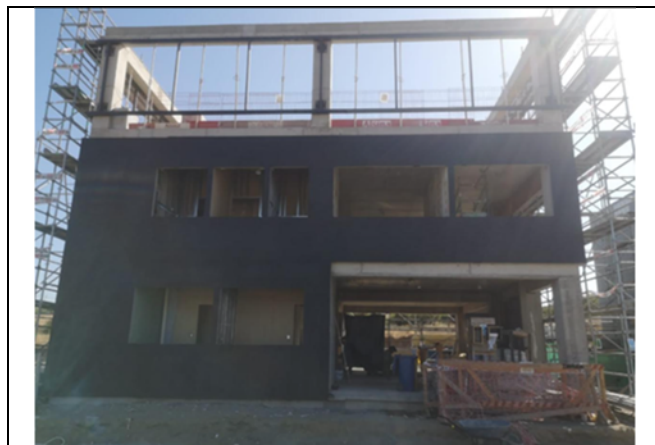
Edificio de administración e IF en Área de Servicios
